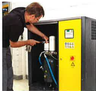
Sparkommissar: Der Servicemann untersucht die Anlage
