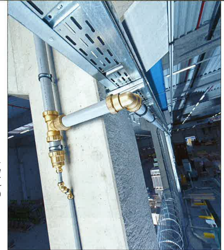
Rohrleitungssystem (Fotos: Schneider Druckluft)
