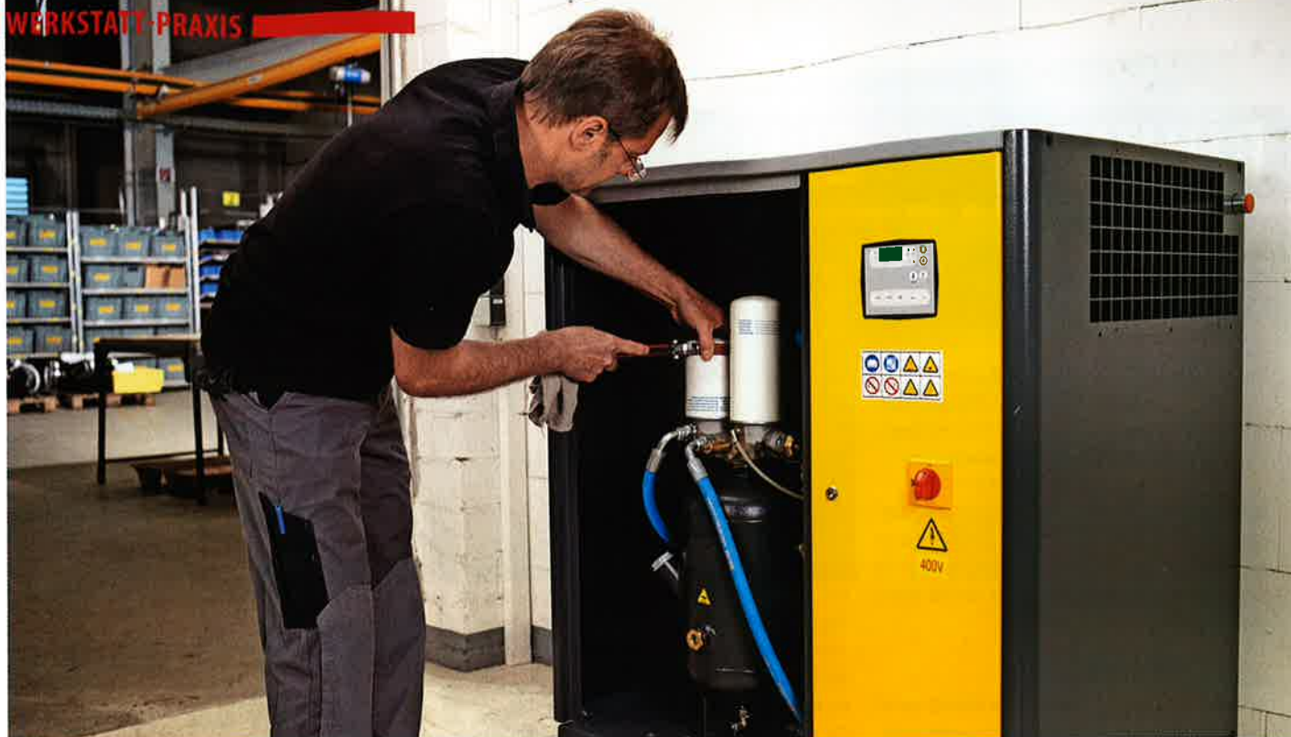
Hohe Betriebssicherheit bei höchstem Bedienkomfort. Dazu gehört natürlich auch eine regelmäßige Wartung. (Foto: Schneider)
