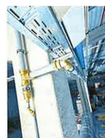
Länge, Durchmesser, und Volumenstrom sollten bei den Rohren aufeinander abgestimmt sein
