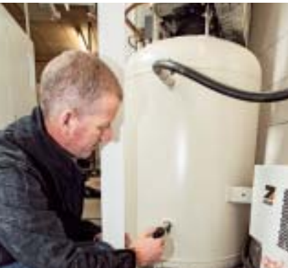
Vorbereitung der Energieeffizienzmessung durch den Druckluftspezialisten
