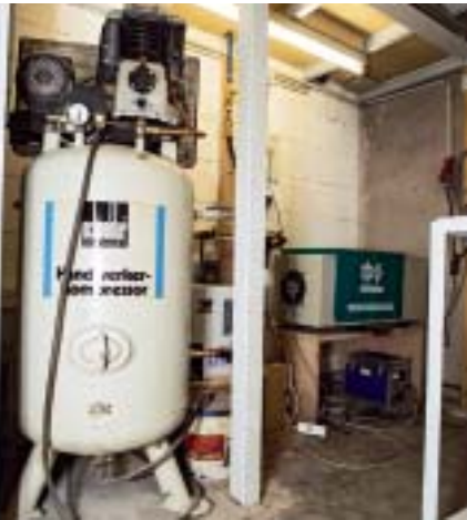
Der vorhandene Kolbenkompressor ist mit einem mit 270 l-Behälter ausgestattet
